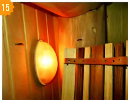
15 Для освещения парилки установили жаростойкие светильники.
