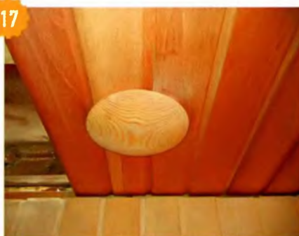
17 На потолке установили анемостат вытяжной вентиляции.
