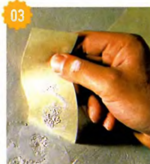
Проверка прочности штукатурки: сорвать приклеенную к стене малярную ленту. Если на ней остались частицы штукатурки, стену надо зашпаклевать.
